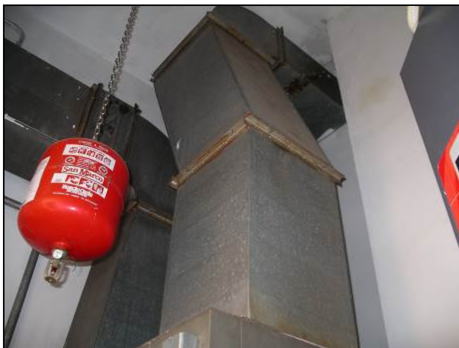
Figura 13: Dettaglio canalizzazione di distribuzione in centrale termica
