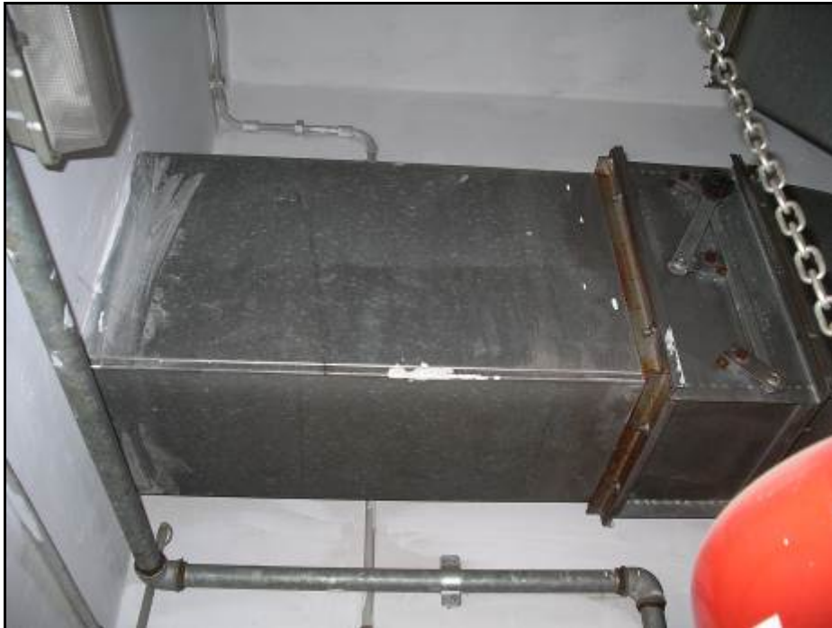
Figura 12: Canalizzazione di ripresa aria ambiente
