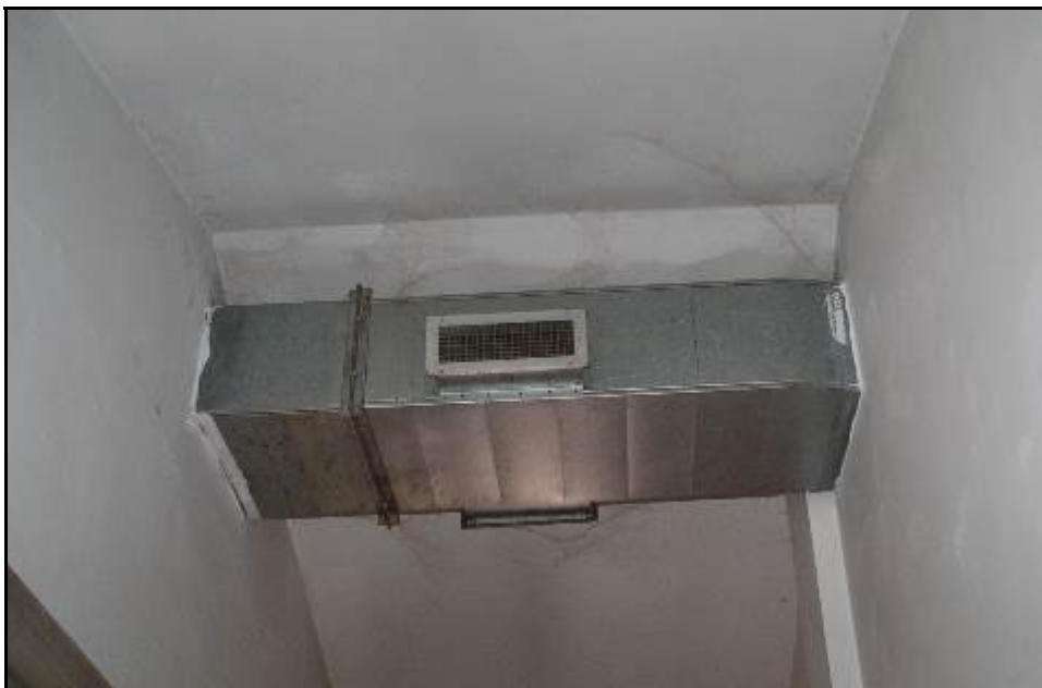
Figura 15: Dettaglio bocchette di emissione
